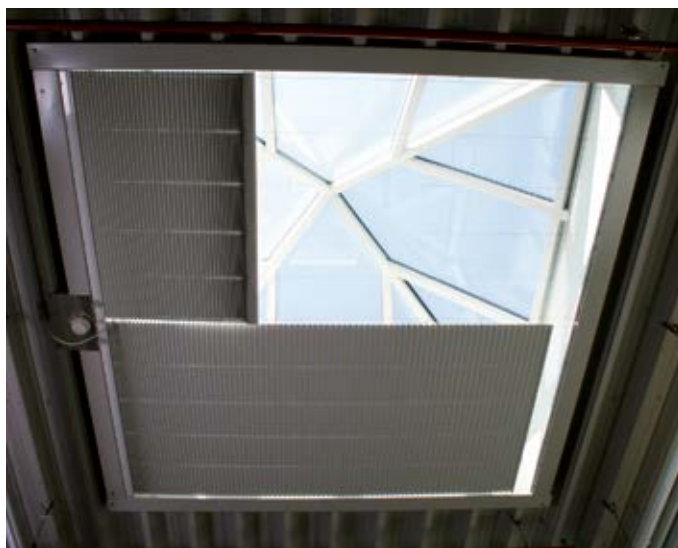
Abb.: Durch eine effiziente Verschattung, wird das Tageslicht optimal genutzt.
