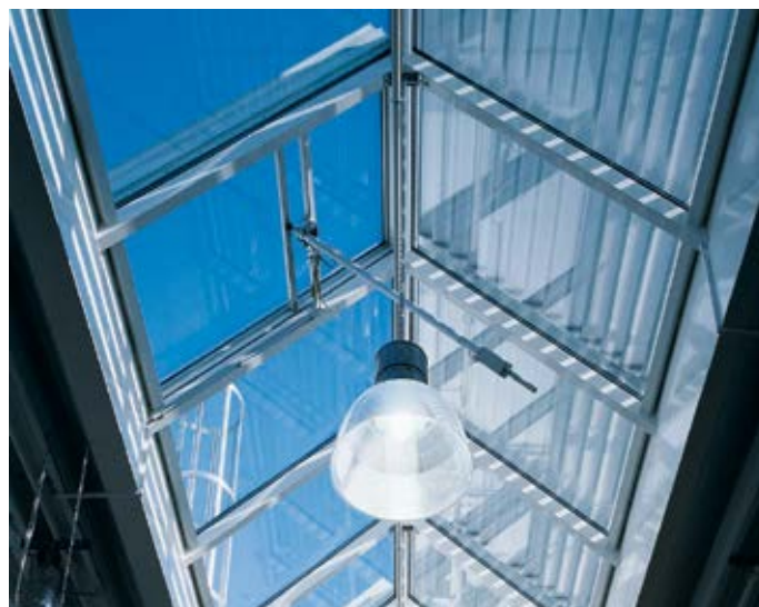
Abb.: Die Kombination von Lüftung und Verschattung ist die optimale Lösung für große Räume.
